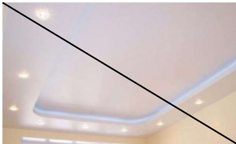
Плохо Многоуровневые гипсокартонные конструкции
